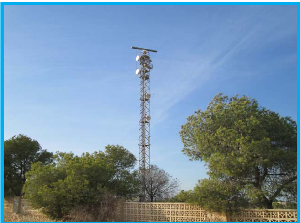
Torre de telecomunicaciones
