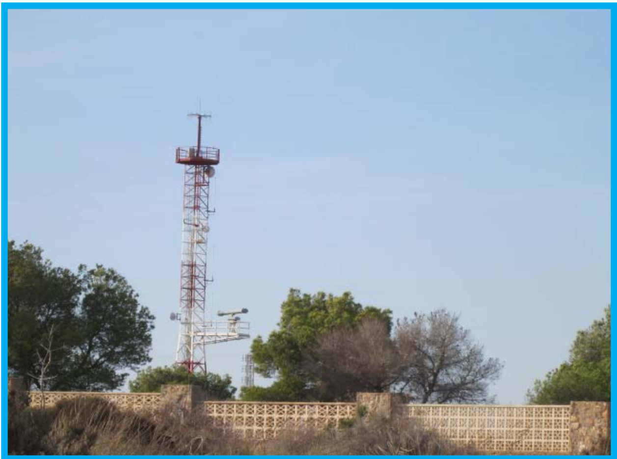
Torre de telecomunicaciones
